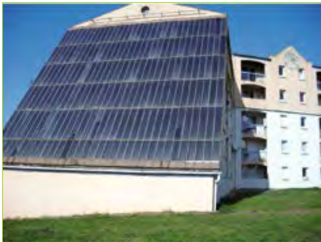
7. Des capteurs solaires thermiques sur la façade d'un immeuble collectif à Blagnac (Haute-Garonne).
